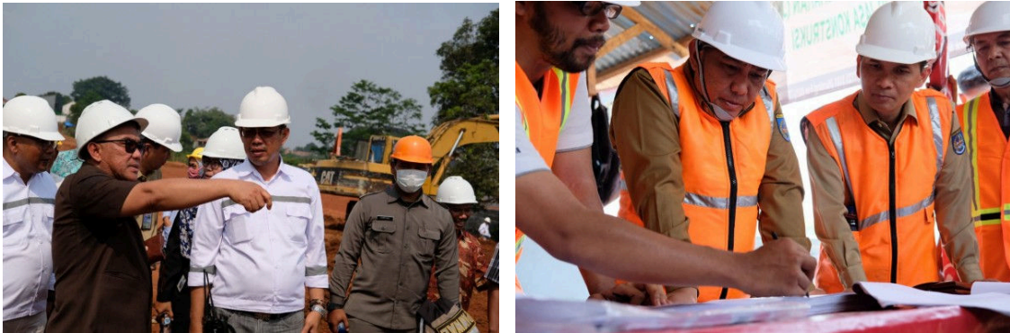
Foto: Wali Kota Depok meninjau pembangunan Alun-alun Kota Depok Tahap I dan Stadion Merpati Kota Depok
